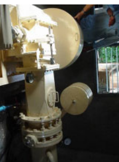
เครื่องกำเนิดไฟฟ้าขนาด 40 กิโลวัตต์ ที่บริการชุมชนไฟฟ้าพลังน้ำป่าแดงบ้านป่าแดง ตำบลป่าแดง อำเภอแม่ออน (ที่มา: กลุ่มวิจัย) 40 kW micro-hydro generator at Mae Kam Pong (Photo: Palang Thai)
